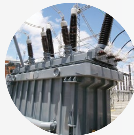
Transformateurs de puissance
