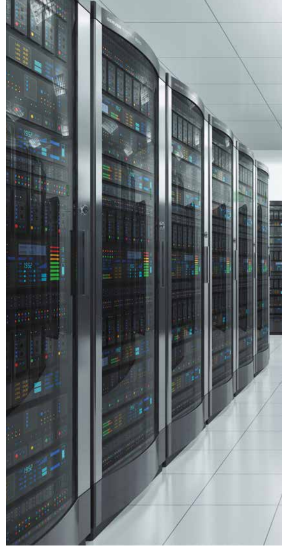
Auch der Betrieb von Rechenzentren ist auf einen zuverlässigen Generatorbetrieb angewiesen.
