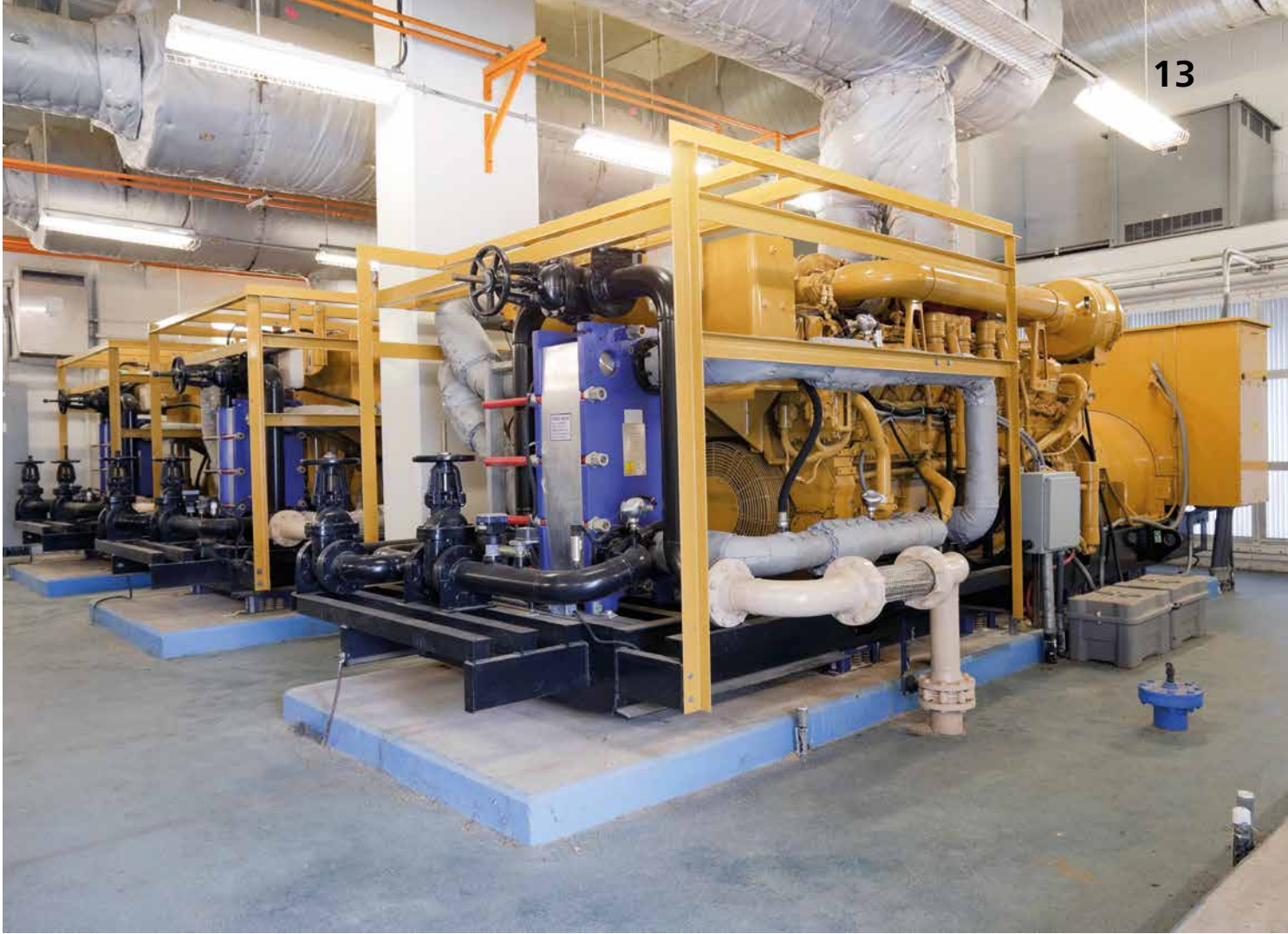
Kunden der Gaal Umwelttechnik betreiben vor Ort Mittelspannungsgeneratoren zur Sicherstellung einer zuverlässigen Stromversorgung.
