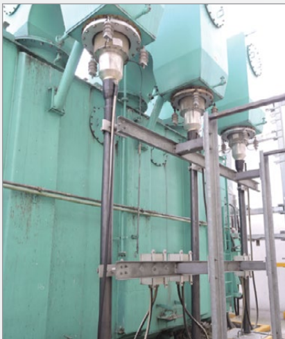
Kabelendverschlüsse eines kurzen 230-kV-Kabelsystems
