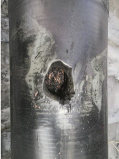
Durchbruch der Isolierung am Kabelendverschluss
