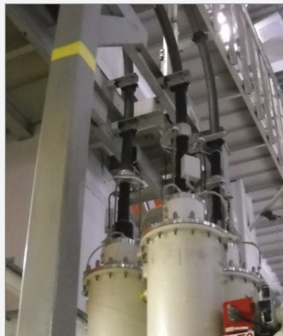
Kabelendverschlüsse eines 380-kV-Erdkabelsystems
