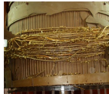
Affaissement de l'enroulement de prise
