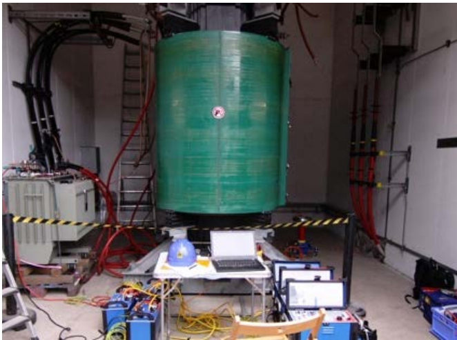
Abbildung 11. TE-Messung an einem 17-MVA-Gießharztransformator mit drei CPC 100s
