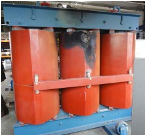
Abbildung 7. Fehler für Durchschlag an Gießharztransformator
