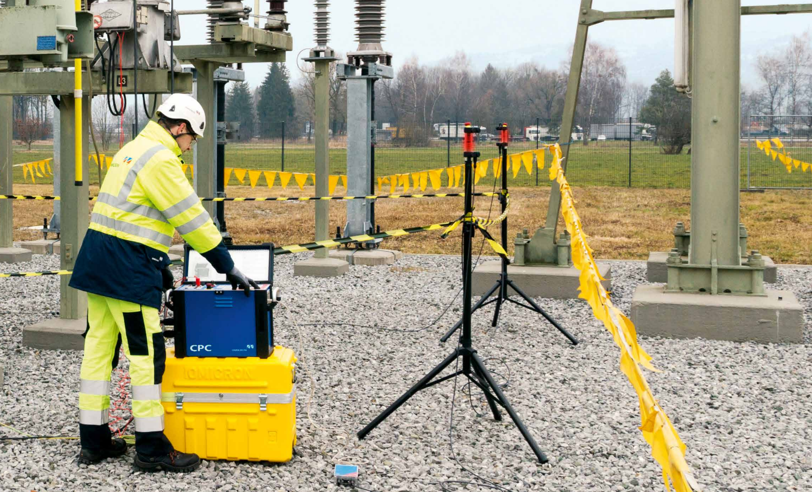
SAA2 en uso in situ durante las pruebas del transformador.
