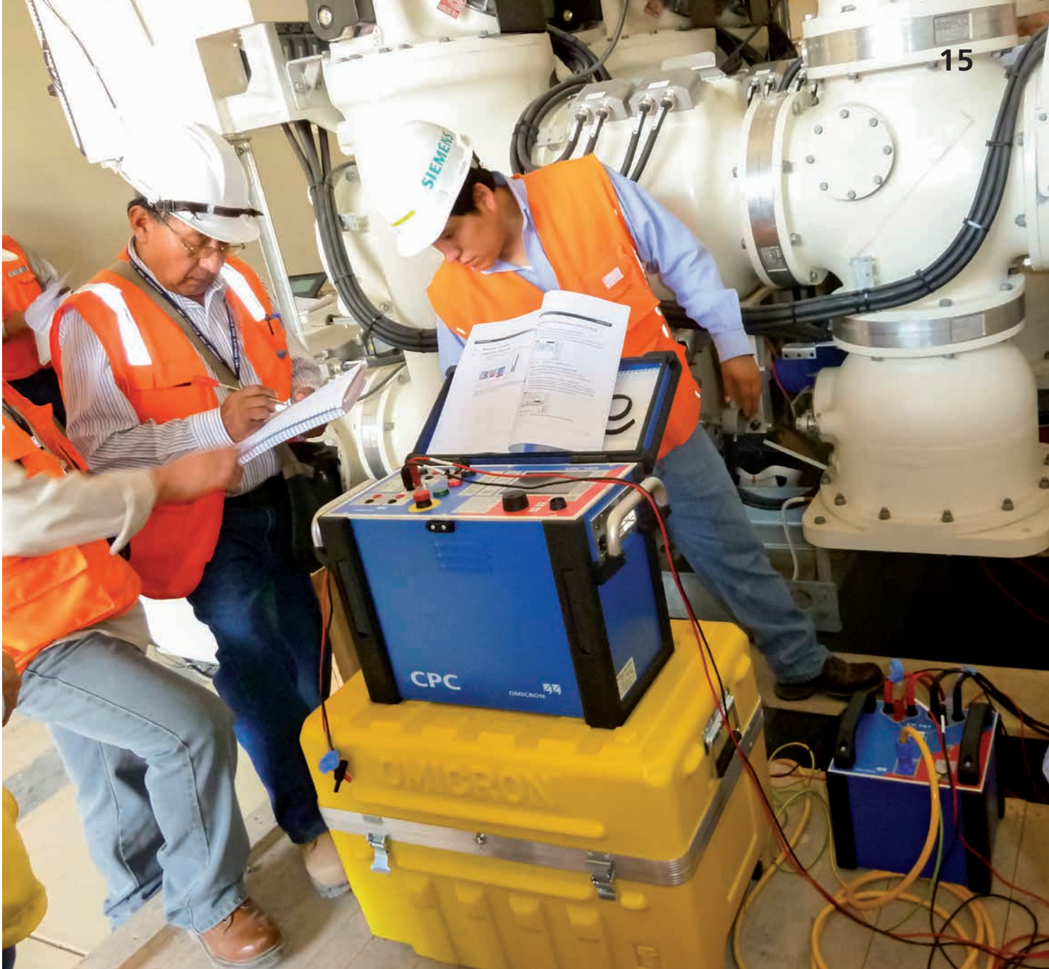
Prüfung einer 72,5-kV-GIS vom Typ 8DN8-4 mit dem Prüfsystem CPC 100 + CP RC.
