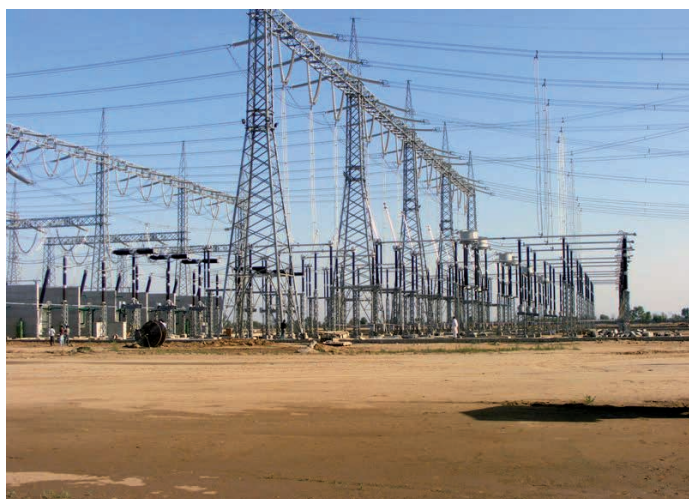
Bei der Inbetriebnahme einer 500/220/132kV AIS Schaltanlage in Pakistan wurde das CPC 100 eingesetzt.
