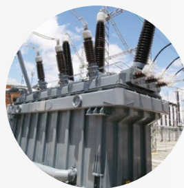
Transformadores de potencia
