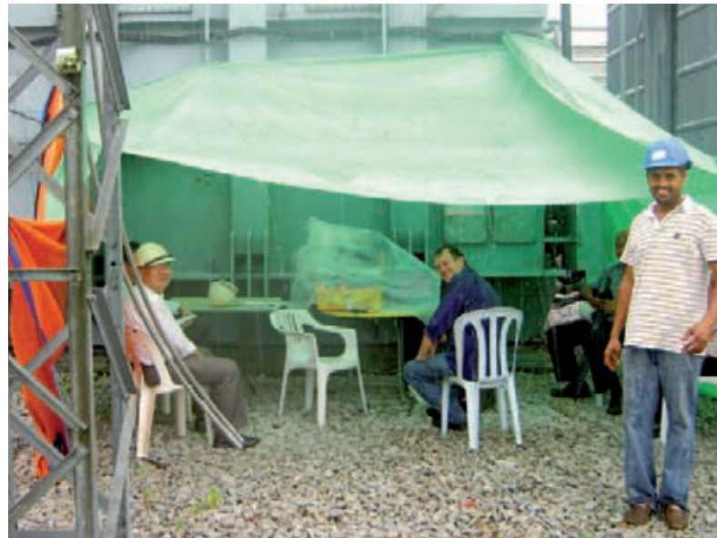
Malaysia – Transformatoröl-Diebstahl: Das Team bei der Prüfung der dielektrischen Eigenschaften eines Leistungstransformators mit DIRANA bei starken Regen.
