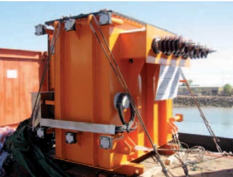
Singapur – Transportschäden: Die DIRANA-Messergebnisse wiesen im Gegensatz zu den Erwartungen auf eine intakte Isolation des Transformators hin.
