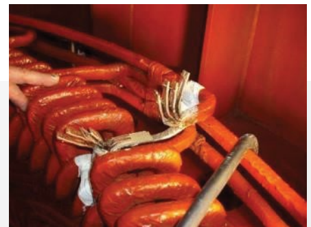
Contacto de soldadura deficiente
