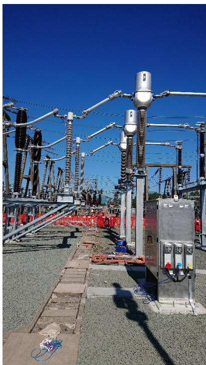
Рис. 7: испытание с применением устройства CPC 100, при котором испытательный ток проходит через трансформаторы традиционной и нетрадиционной конструкций.
