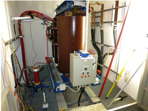
Figura 9. Configuración de medición de DP en un transformador con aislamiento de resina fundida de 20 kV / 2 MVA
