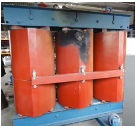
Figura 7. Falla por rotura en transformadores aislados con resina fundida
