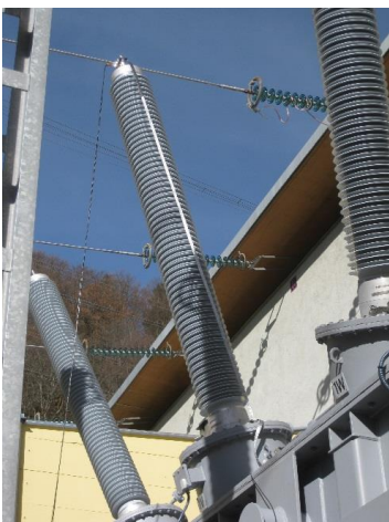
Abbildung 7: Messung von CHL an einem Zweiwicklungstransformator ohne bzw. mit Guard
