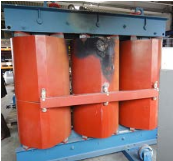
Figure 7. Défaut sur un transformateur encapsulé
