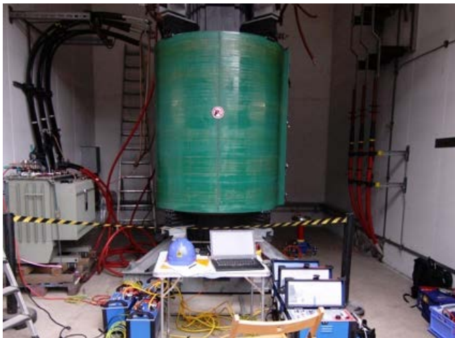
Figure 11. Mesure de DP sur un transformateur encapsulé de 17 MVA avec trois CPC 100
