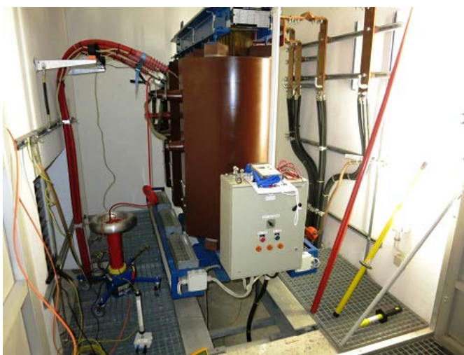
Figure 9. Configuration des mesures de DP sur un transformateur encapsulé de 20 kV/2 MVA
