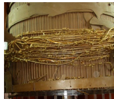
Обмотка с деформированным отводом
