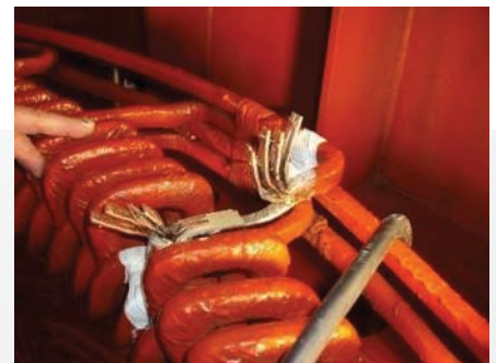
Mauvais contact à braser
