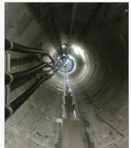
Jonctions d'un système de câbles en tunnel de 380 kV
