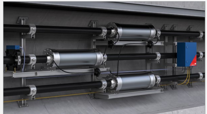
Surveillance des DP au niveau des jonctions de permutation d'un système de câbles en tunnel
