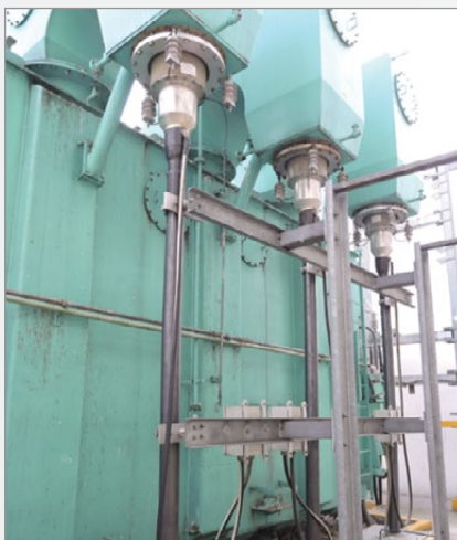
Extrémités d'un système de câbles courts de 230 kV
