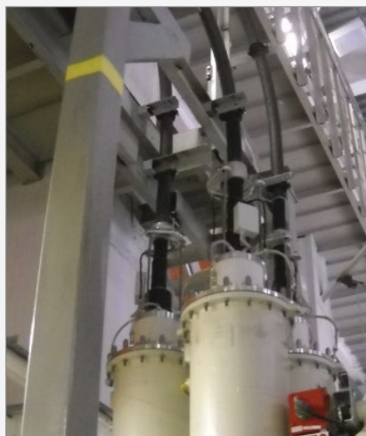
Extrémités d'un système de câbles enterré de 380 kV
