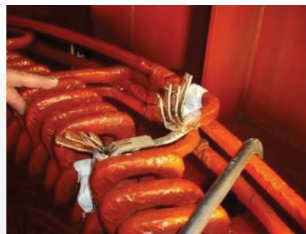
Ремонт повреждения в месте пайки
