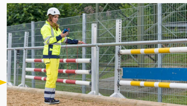
Pomiar napięcia krokowego i napięcia dotykowego z użyciem miernika ręcznego HGT1
